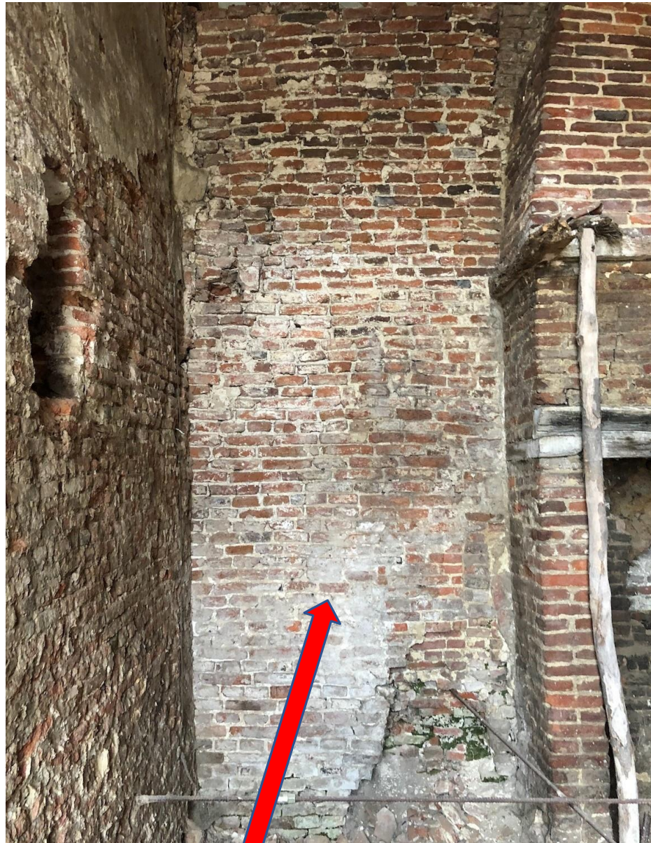
Niet ingebonden onstabiele muur verbergt de spiltrap
