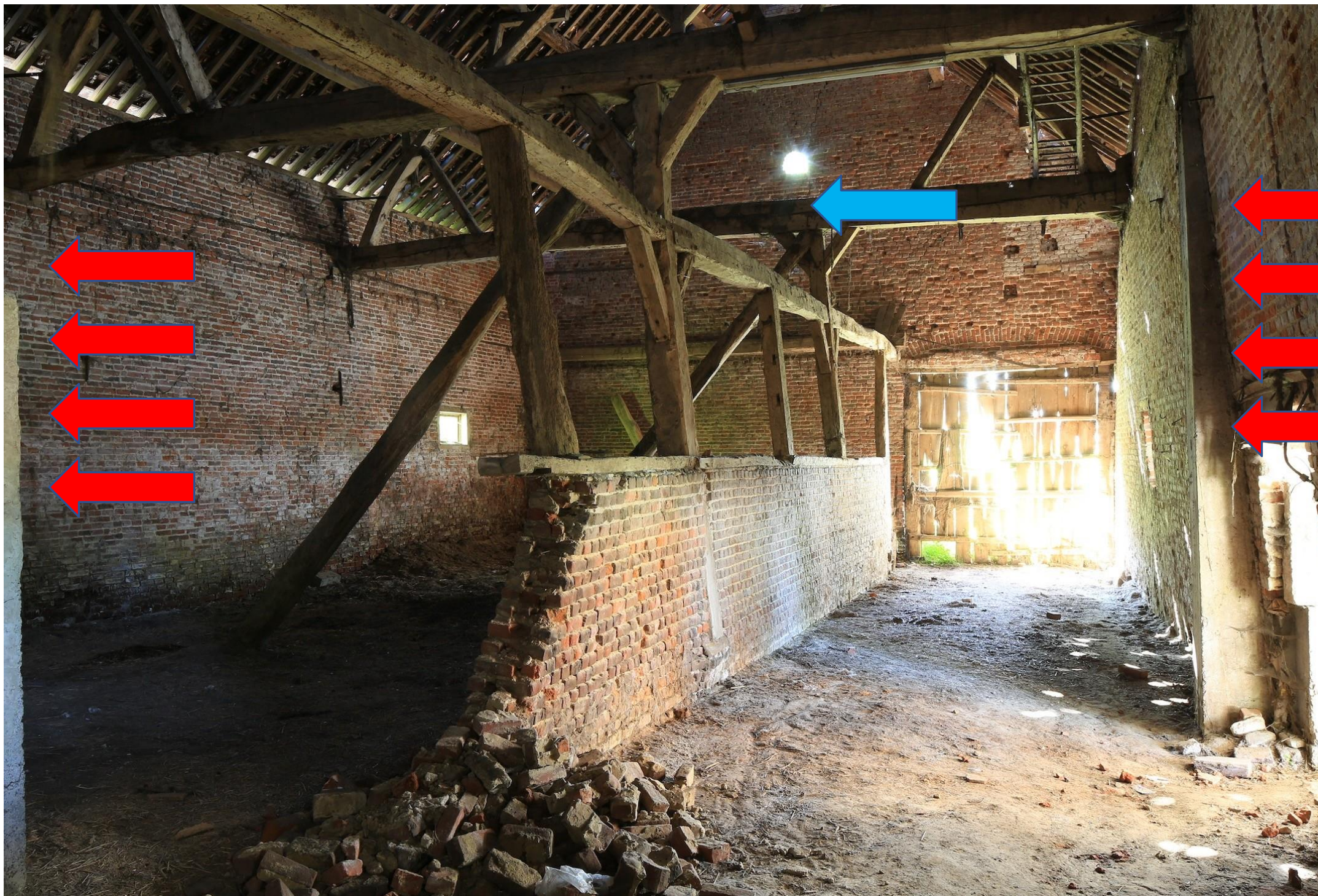
Scheeftrekking door rotatie van koermuur met wegdrukken van zuidelijke muur via moerbalken van de spanten (blauw)
