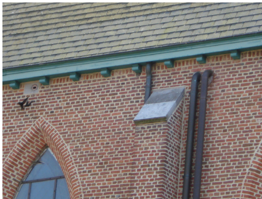
Foto: Voorbeeld van een ingemetselde neststeen: Openingen voor Gierzwaluw in een kerkegevel waarbij gebruik werd gemaakt van de niet langer functionele steigergaten (Bron: Wim Debock)
