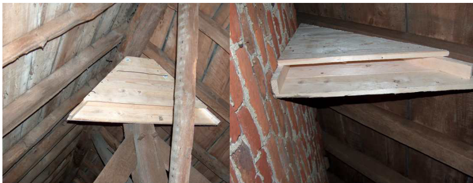
Twee voorbeelden van losse microverblijfplaatsen die zijn aangebracht op de zolder van de kerk van Houwaart in opdracht van het Regionaal Landschap Noord-Hageland. (foto's Sven Verkem)
